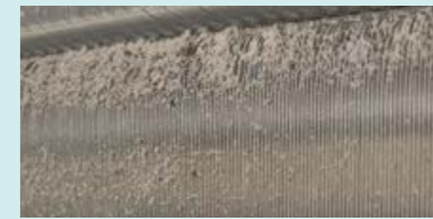
Prim-plan al unui schimbător de căldură după aproximativ 10 ani de utilizare continuă fără un sistem de spălare intern. Nivelul de praful și bacterii prezente depinde de mediul în care este instalat aparatul de aer condiționat.
